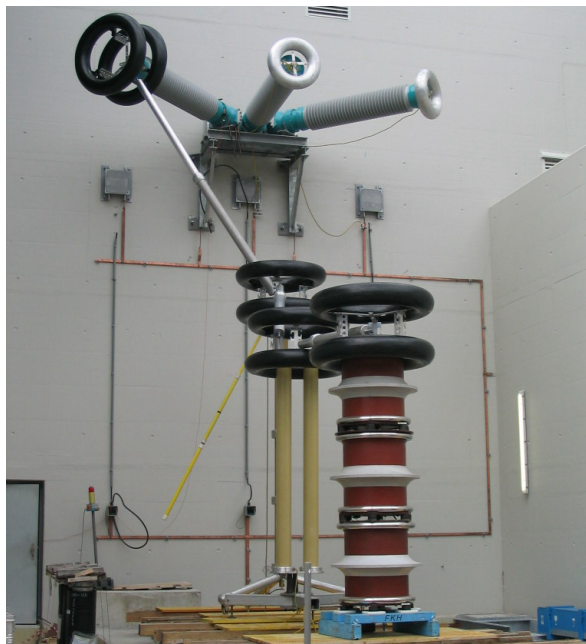
Installation à résonance série pendant l'essai d'un PSEM 170 kV (injection par les bornes de la liaison transfo)
