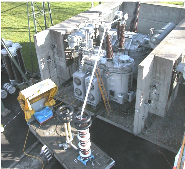
Teilentladungsmessung an einem Regulierpol eines Netzkupplerttransformators in einem Unterwerk: Erregung mit Hilfe der FKH-Serieresonanzanlage
