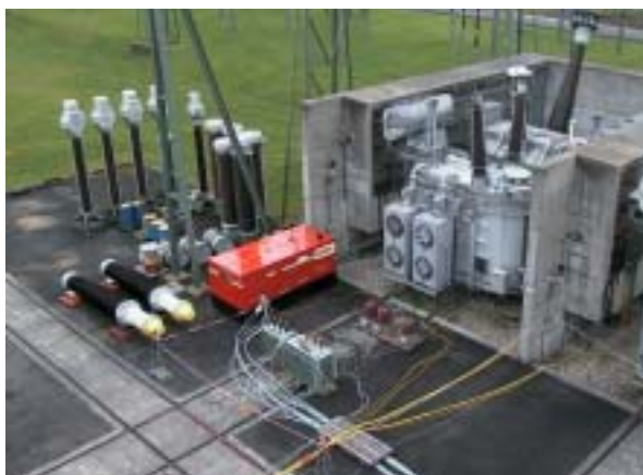
Bild 1 Prüfspannungserzeugung an einem 600 MVA Netzkupplungstransformator mittels Diesel-Generator (nur ein Hauptpol mit Regulierpol abgebildet, Bildmitte: Step-Up-Transformator und Generator)
