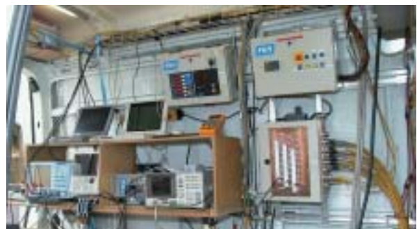
Bild 5 Messeinrichtung zur TE-Erfassung (eingebaut in Messfahrzeug): v. l. n. r.: zwei Oszilloskope (DSO), Impulsverarbeitungssystem (ICM), Spektrumanalysator, „Switch-board“; oben: Steuerung der Spannungsquelle
