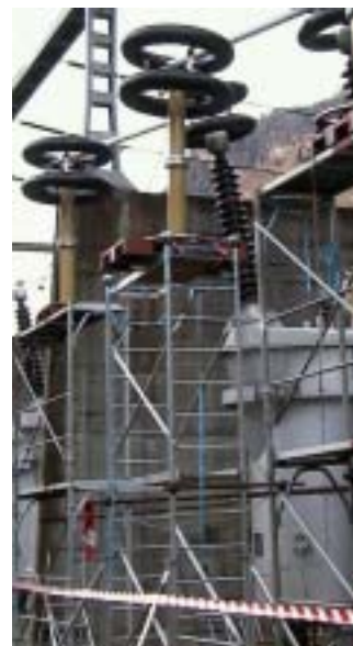
Bild 9 TE-Messung mit externen Koppelkondensatoren (Durchführungen ohne Messanschluss). Die Verbindung zwischen Koppelkondensator und Durchführungsanschluss ist TE-frei mit Rohrverbindungen ausgeführt
