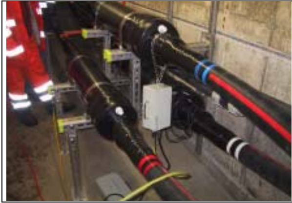
Bild 9 Verstärker und Messkabel im Muffenschacht
