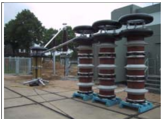
Bild 7 Koppelkondensator, Spannungsteiler, Freiluftendverschluss, Resonanzdrosseln
