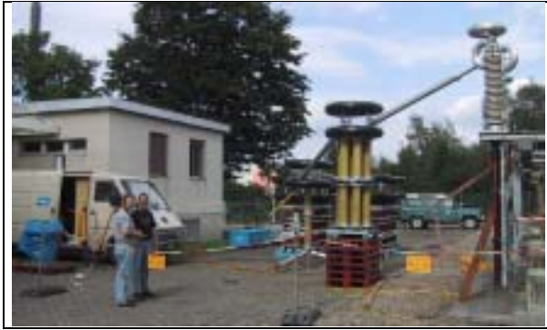
Bild 13 Prüfanlage mit Koppelkondensator, Freiluftendverschluss
